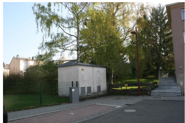
Vue sur le transformateur à déplacer
