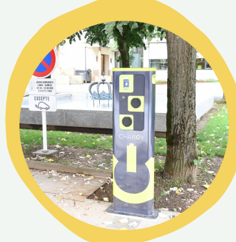
Borne chargy rue du parc
